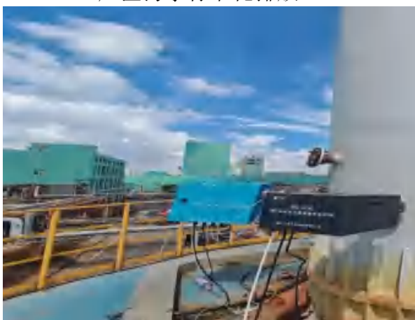
RTO 废气采样平台
