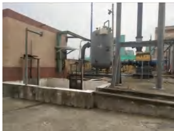
厂区雨水排放口
