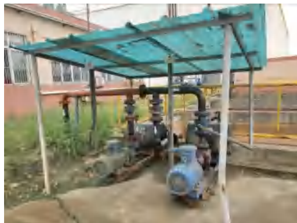
厂区事故应急池水泵
