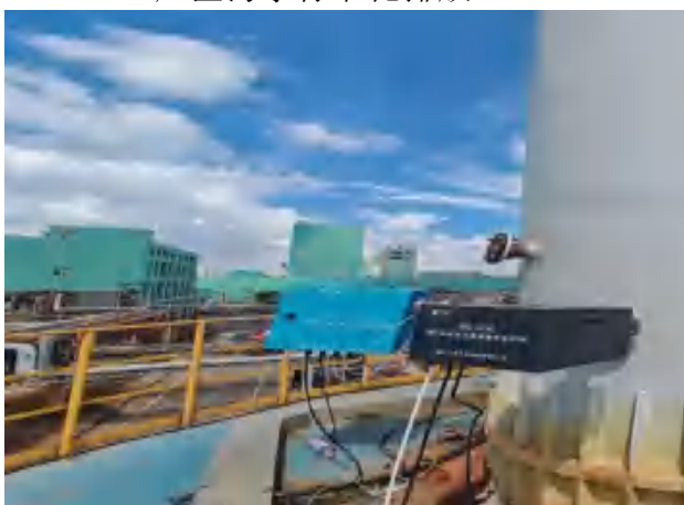
RTO 废气采样平台
