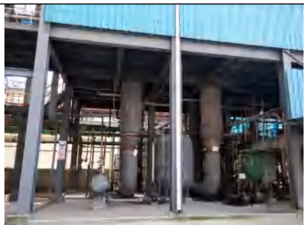
二效蒸发装置
