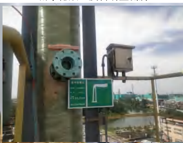
废气排放口标识
