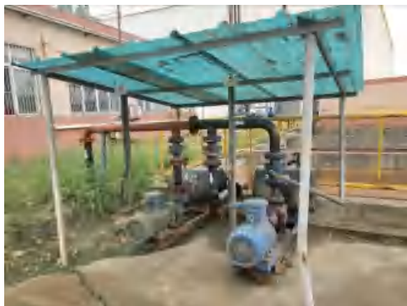
厂区事故应急池水泵
