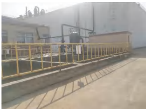
事故废水收集池
