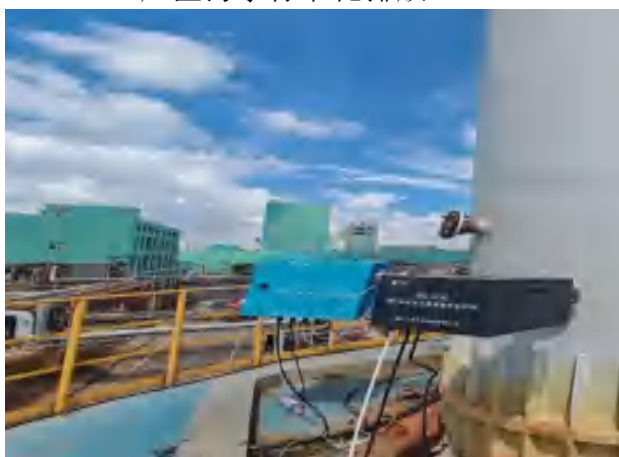
RTO 废气采样平台
