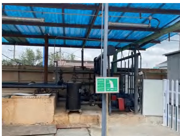
厂区污水标准化排放口
