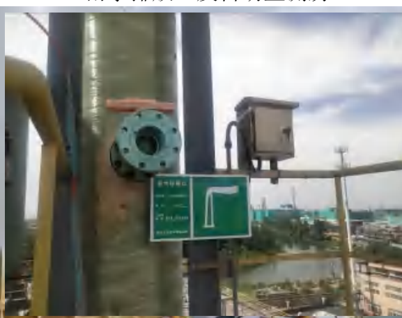
废气排放口标识
