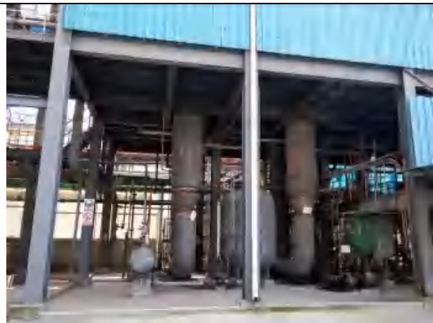
二效蒸发装置
