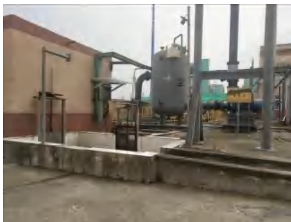
厂区雨水排放口
