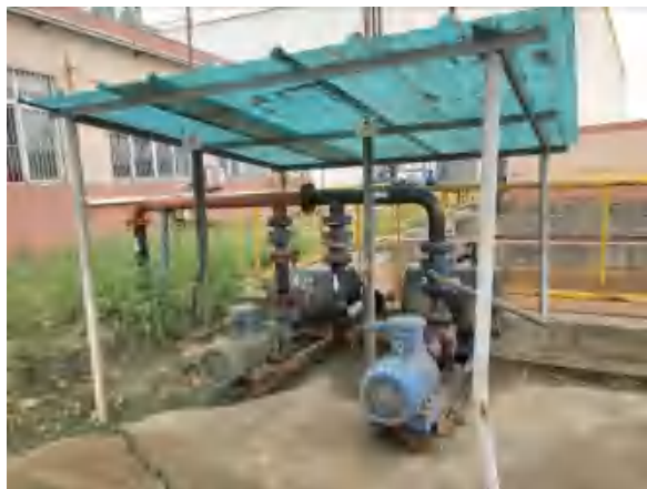
厂区事故应急池水泵
