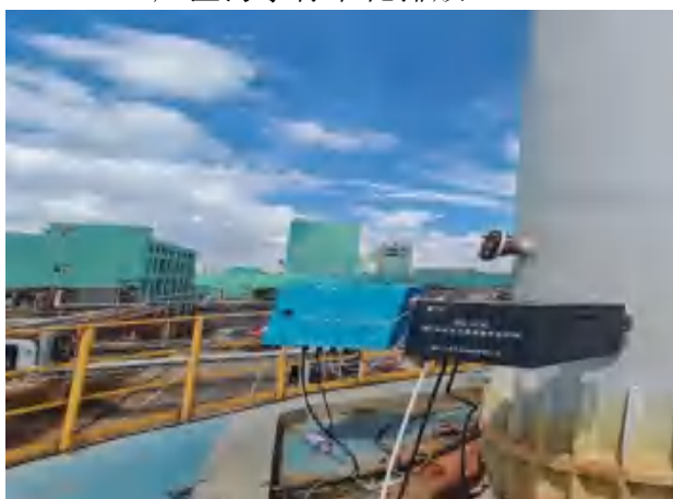
RTO 废气采样平台
