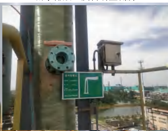
废气排放口标识
