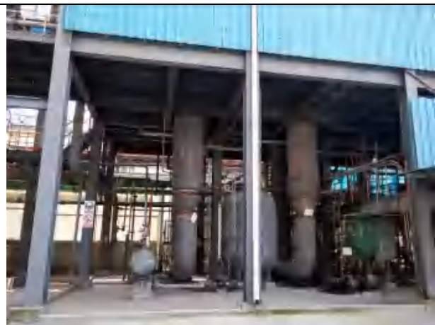
二效蒸发装置
